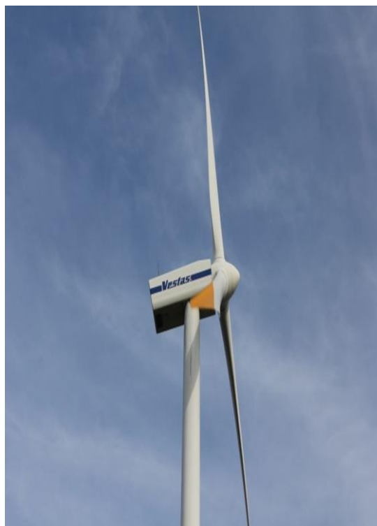
Rys. 2. Gondola oraz wirnik turbiny VESTAS V80-2,0 MW
